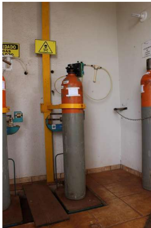
Figura 13: Cilindros de Gás Cloro.
