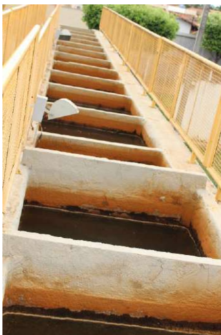
Figura 10: Vista parcial dos Floculadores.
