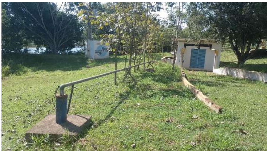
Figura 6: Estação Elevatória de Água Bruta .
