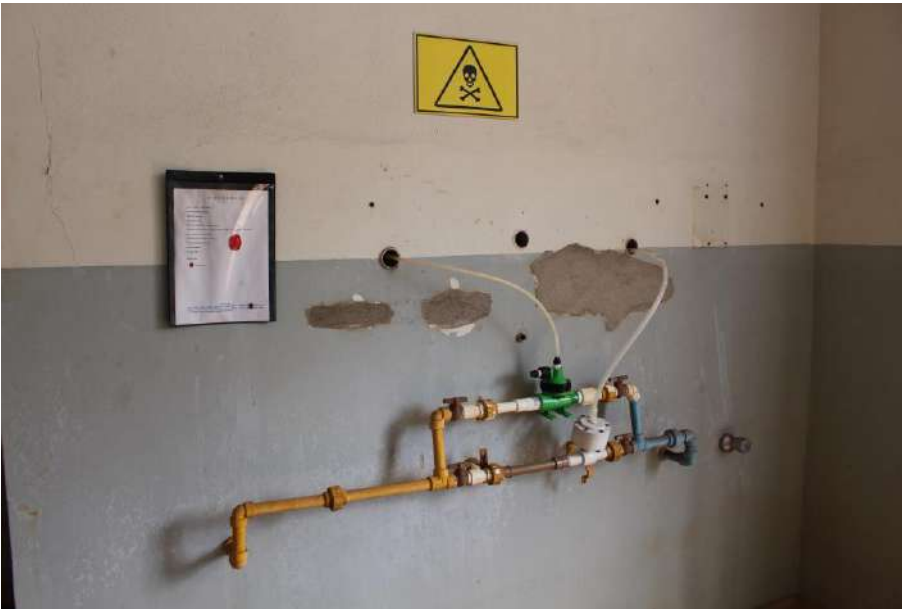
Figura 14: Vista Geral da Sala de Dosadores de Cloro Gás
