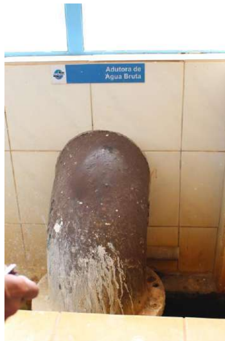
Figura 9: Entrada de Água Bruta na ETA.
